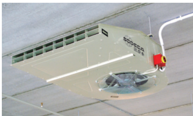
Вентилятор CI, установленный в автостоянке
