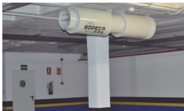
Вентилятор THT/IMP, установленный в автостоянке
